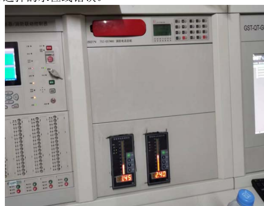
图6 消控室液位仪显示不正确
