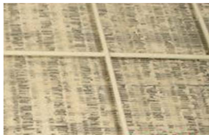
图4空气冷却器翅片堵塞严重
