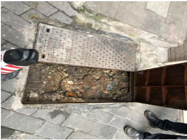
d. 化粪池堵塞
