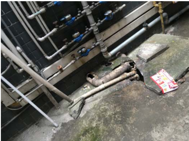
b. 管道破损
