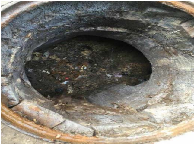
c. 管道堵塞
